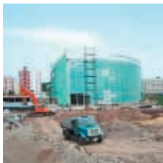
Дом дружбы народов Внутренние работы по выравниванию и гидроизоляции полов материалами Р1, Р3, Кп+, Т гидро, Гидроэласт, Актив водопреграда
