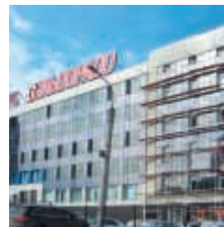
Мегаполис (новый корпус) работа по облицовке плиткой с помощью клея В, Праймера Суперконтакт, Грунт 3 клеевым составом Плитонит В, Грунт СуперКонтакт, Грунт 1.
